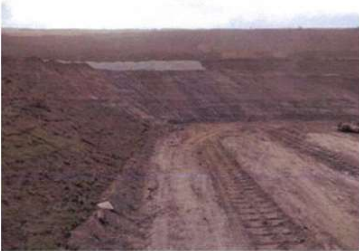
Figura 1 - Ausência de canaleta em berma
