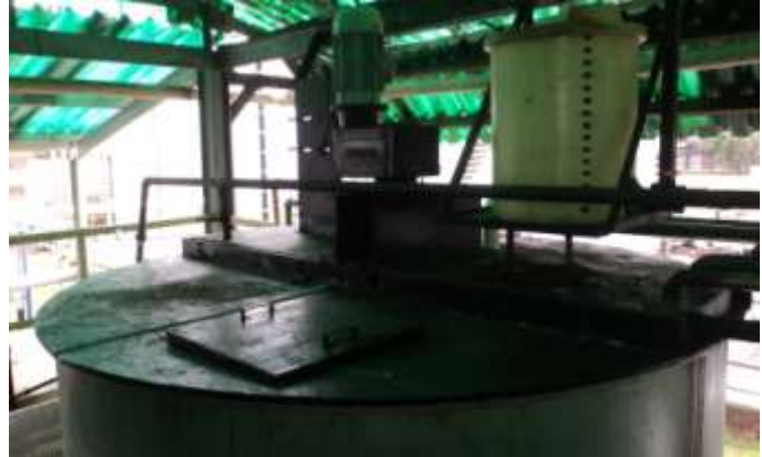
Vista geral das dornas de preparação de emulsões asfálticas, observando-se certa precariedade da instalação.
