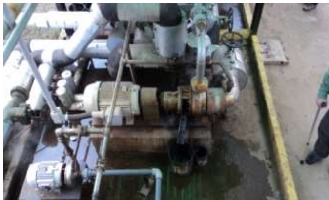
Visto superior da área de bombas, filtros e componentes, observando-se áreas com a presença de compostos em contato com o ar.
