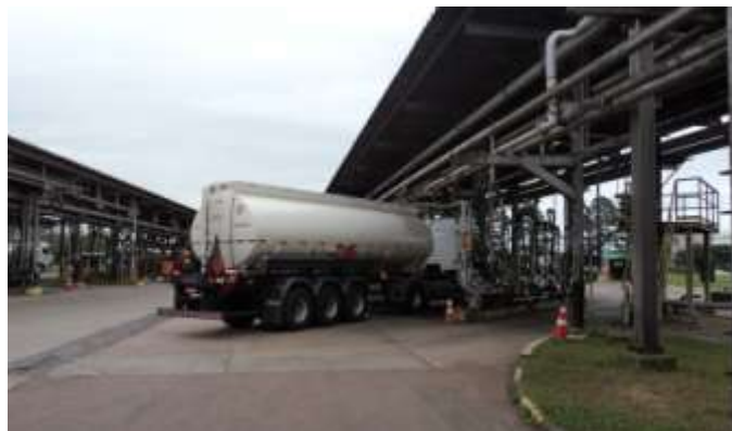
Vista geral de uma das plataformas de carregamento botton loading .
