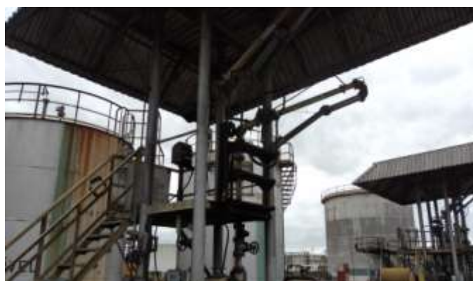
Vista de plataforma de carregamento top loading da Rua 3 do complexo, observando-se ausência de sistemas de proteção coletiva contra a exposição a agentes tóxicos.
