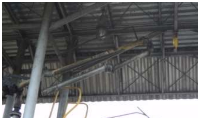
Braço de carregamento utilizado no processo de carregamento top loading .
