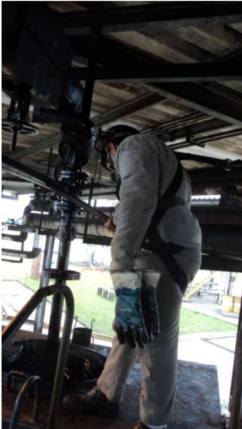
FOTO 01: TRABALHADOR LIGADO À EMPRESA SERVILIT EXECUTANDO OPERAÇÕES DE CARREGAMENTO, A QUENTE, DE COMPOSTOS ESCUROS EM PLATAFORMA DO TERMINAL DA PETROBRÁS DISTRIBUIDORA. OBSERVE-SE A NÃO EXISTÊNCIA DE SISTEMA DE PROTEÇÃO COLETIVO, EM CONDIÇÃO DE EVIDENTE EXPOSIÇÃO A FRAÇÃO VOLÁTIL TÓXICA DESTES COMPOSTOS. PEQUENOS RECIPIENTES METÁLICOS SÃO UTILIZADOS PARA COLETAR AMOSTRAS E RESÍDUOS LÍQUIDOS DO BRAÇO DE CARREGAMENTO, CONSTITUINDO-SE EM OUTRA FONTE DE POSSÍVEL EMISSÃO.
